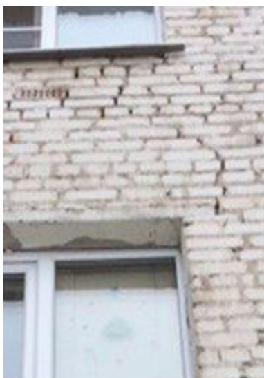
Вертикальная сквозная трещина между этажами
