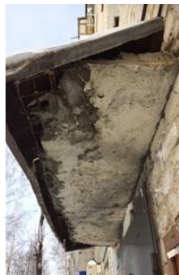
Разрушение бетона под козырьком подъезда
