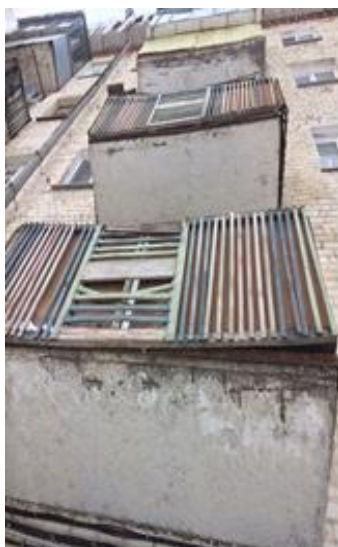
Разрушение ж/б балконной плиты, коррозия арматуры
